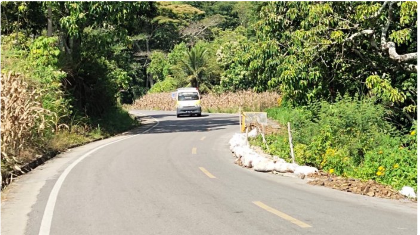
Badan Jalan Amblas di Jalinsum Tomok-Pangururan Desa Marlumba Kecamatan Simanindo
